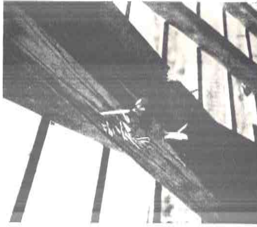
Spur eines Brisanzbombensplinters im Dachgebälk des Hauses B. in der Moosmatt.
